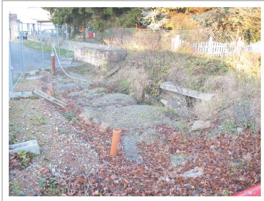
Bild 1: Bodenabsenkung am 02.12.2009. Ansatzstellen ehemaliger Bohrungen aus Dezember 2009 sind durch PVC-Rohre kenntlich gemacht, 02.12.2009
